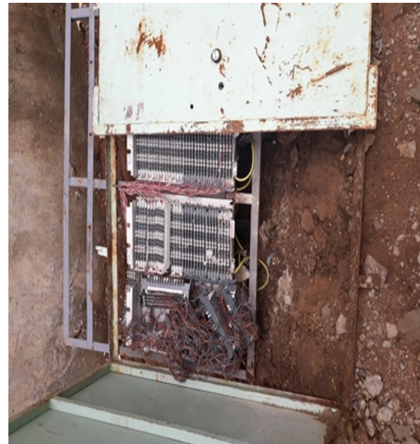
SR endommagé par les travaux de Côte d'Ivoire Energie
