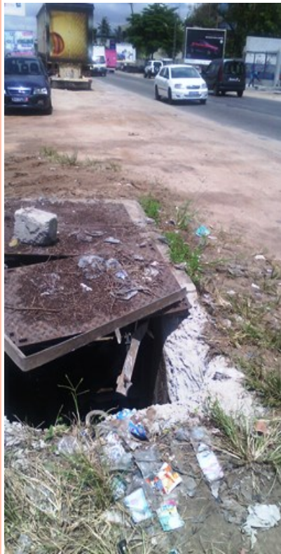
Chambre vandalisée sur Bd de Marseille
