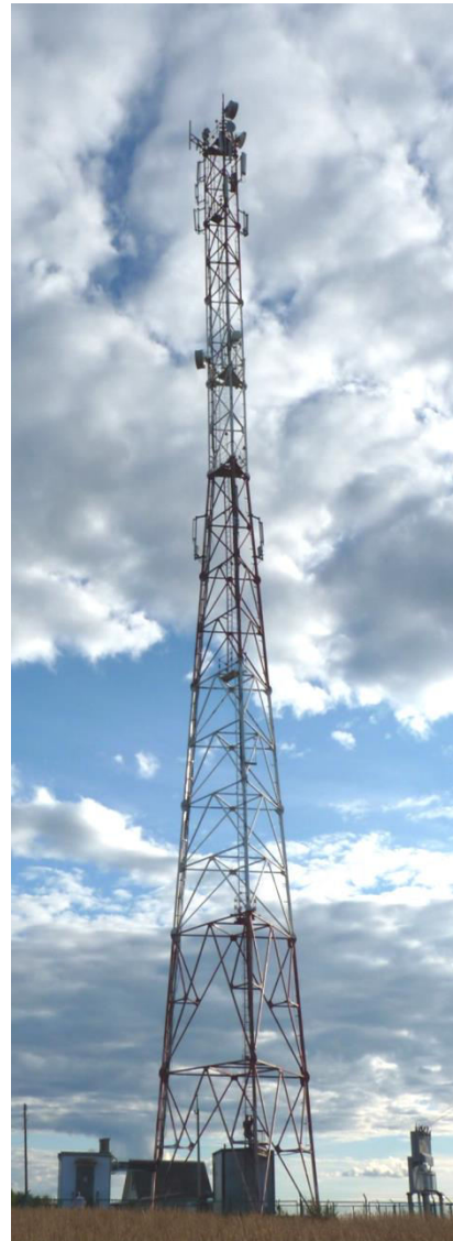
Общий вид сайта BTS энергопотребление около 5 кВт
