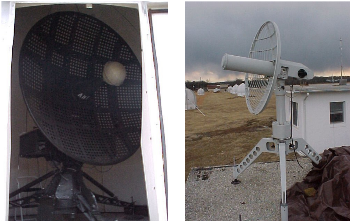
FIGURE 3-7 Antennes de poursuite (1 668,4-1 700 MHz)
