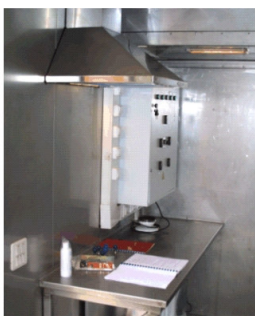
Рабочее место с системой воздухоочистки
