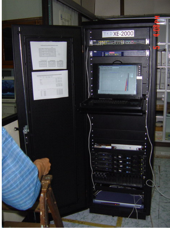
Figure-5: Softswitch in Pematang Siantar
