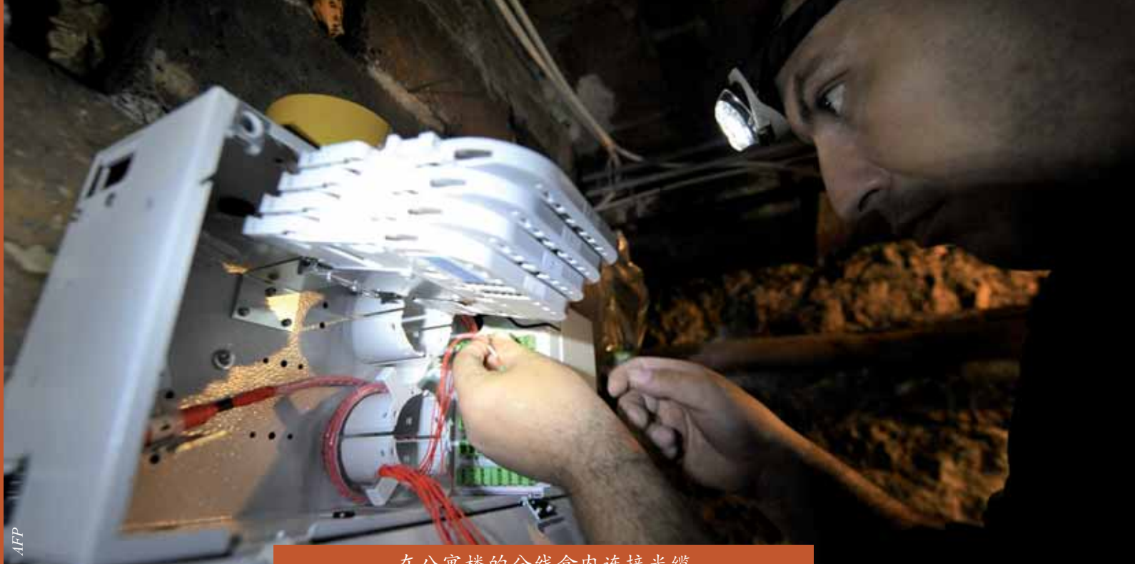
在公寓楼的分线盒内连接光缆
