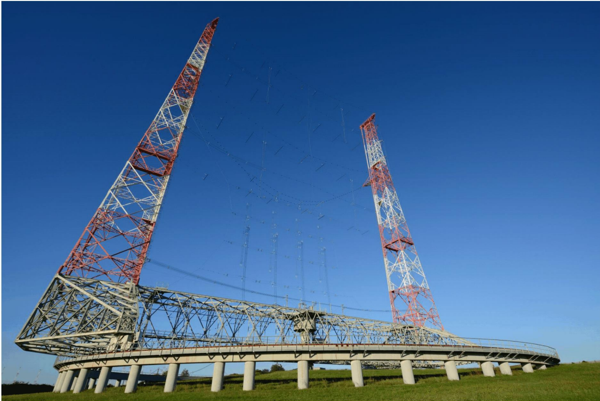
FIGURA 11 Ejemplo de sistema de antenas en ondas decamétricas
