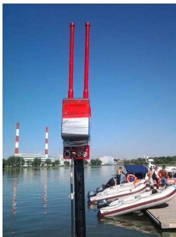
FIGURA A7.18 Estación de acceso inalámbrico en el Centro de Deportes de Remo
